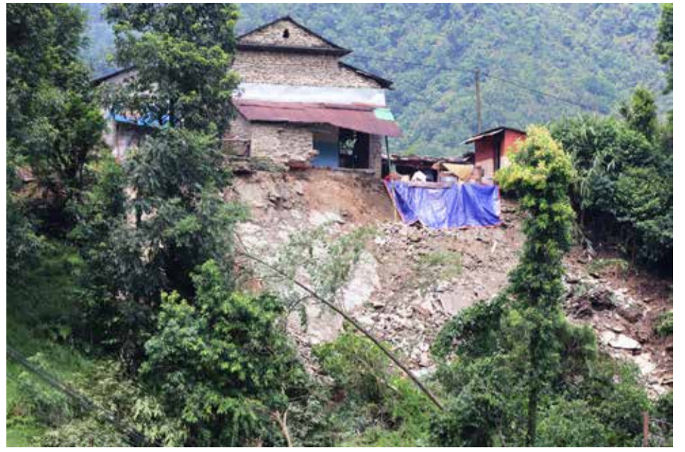
पहिरोले क्षति : पोखरा महानगरपालिका २३ टूलाखेतमा गयराती अविबल वर्षापछिको पहिरोले स्थानीय विष्णुप्रसाद पौडेलको घरका दुई कोठा बगाएपछि क्षतिग्रस्त घर । तस्बिर : कृष्ण दवाडी/रासस
