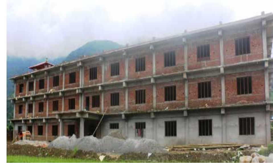
गाउँपालिकाको निर्माणाधिन प्रशासकीय भवन: कास्की जिल्लाको माछापुच्छ्रे गाउँपालिकाको निर्माणाधिन प्रशासकीय भवन । गण्डकी प्रदेश सरकार जिल्ला समन्वय समिति कास्की र गाउँपालिकाका कूल छ करोड ६२ लाख ११ हजारको लागतमा सो भवन निर्माण गर्न लागिएको हो । तस्वीर : हरि बास्तोला/रासस
